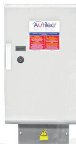
Armoire filtre actifs
