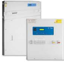
Sources centrales d'éclairage de sécurité
